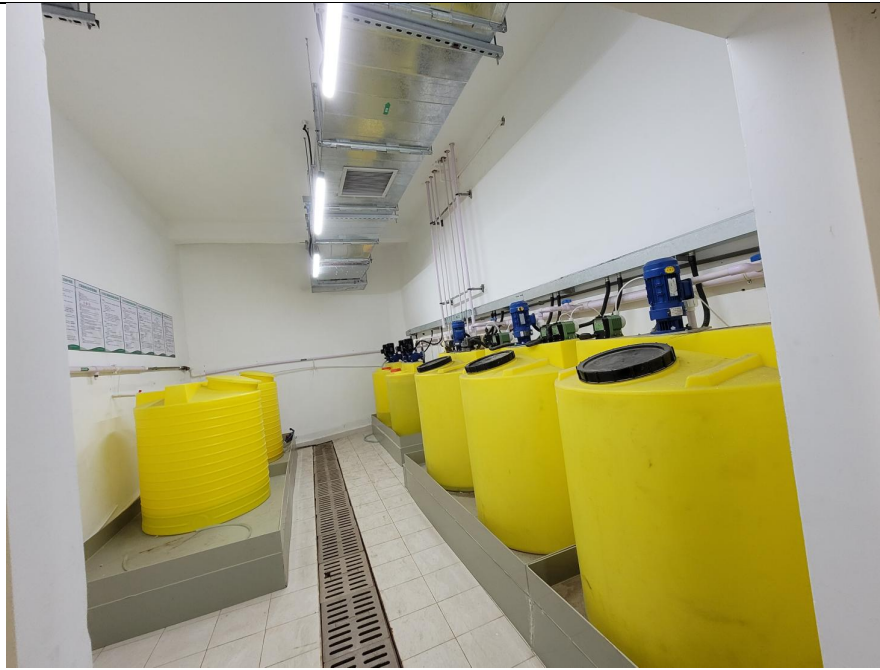
图4 废水治理设备照片
