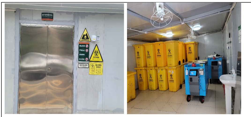
图7 现有工程医疗废物暂存场所图片
